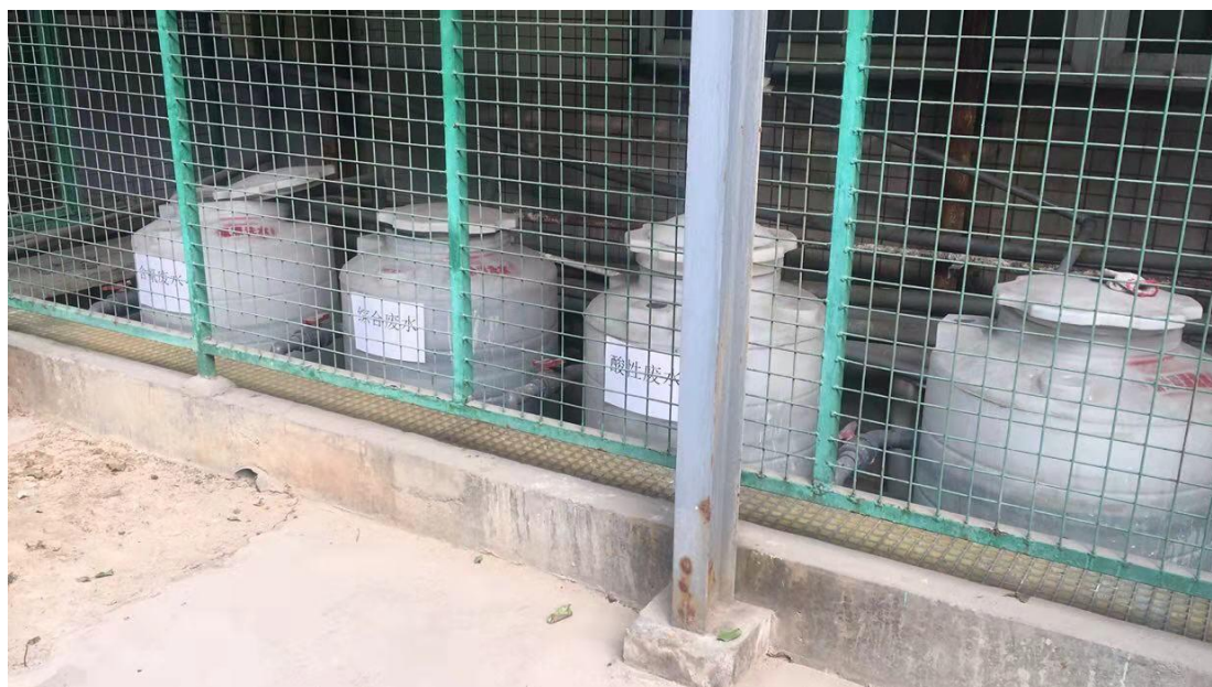
图 7.1-2 废水分类收集罐照片
